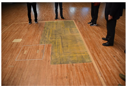
テープで応急処置がしてある封鎖されたステージの「セリ」
