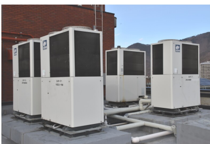
6基中4基が故障しているガスヒートポンプ(GHP)
