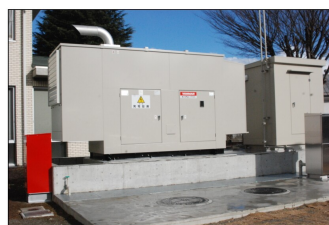
地下1階にあったため水没して大きな被害を受けた発電設備は 屋外へと移動された
